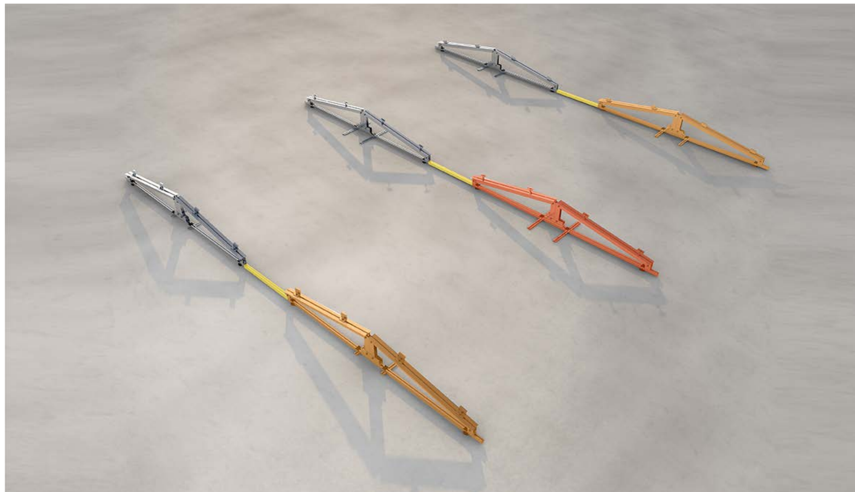
Componentes montados en la superficie de instalación.
